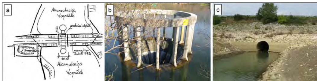
Slika 5: Skica in sliki pretočnega objekta pod HC na odseku Selo–Šempeter, ki povezuje zgornji in spodnji del zadrževalnika. Na skici 5a je viden tudi zadrževalni bazen meteornih vod z lovilcem olj. Na sliki 5b je vtok v pretočni objekt, na sliki 5c iztok iz njega na dolvodni strani pod HC (vir skice: Projektna dokumentacija, 1987; foto: Matjaž Tratnik).
